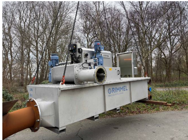
Leihrechen – Flach-Feinsiebrechen im Behälter während einer Umbauphase
