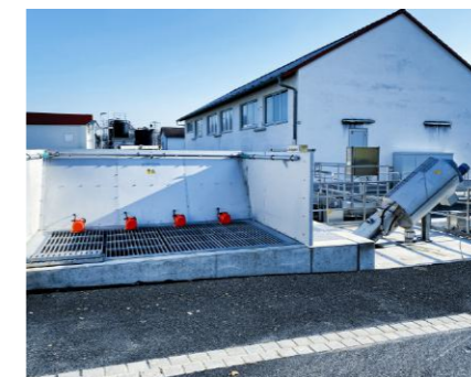
Sandannahmestation – zur Aufnahme von Straßenkehrschutt und Kanalsand
