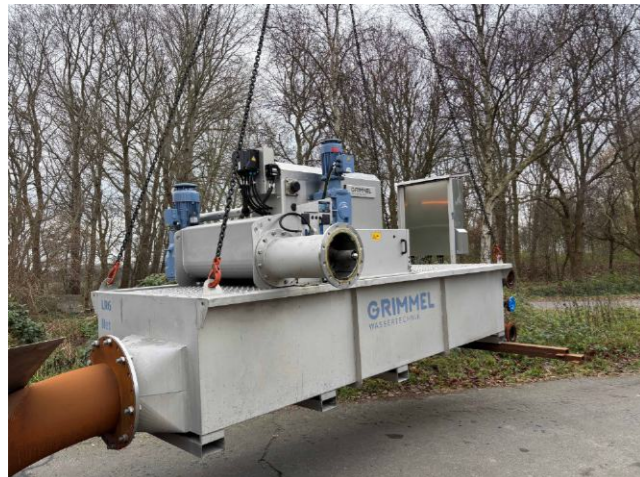
Leihrechen – Flach-Feinsiebmaschinen im Behälter während einer Umbauphase
